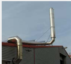
Schalldämpfer von BHKW Silencers of cogeneration plants
