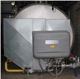
Zweigasbrenner mit O 2 /CO-Regelung an Dampfkessel mit Durchsatz von 5 t/h Two-gas burner with O 2 /CO control at boiler with a flow rate of 5 t/h
