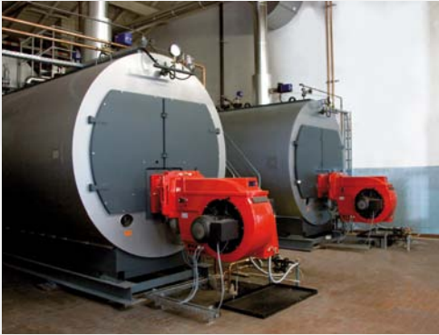
Dampfkessel mit Leistungen von je 6 t/h Steam boilers with output of 6 t/h each
